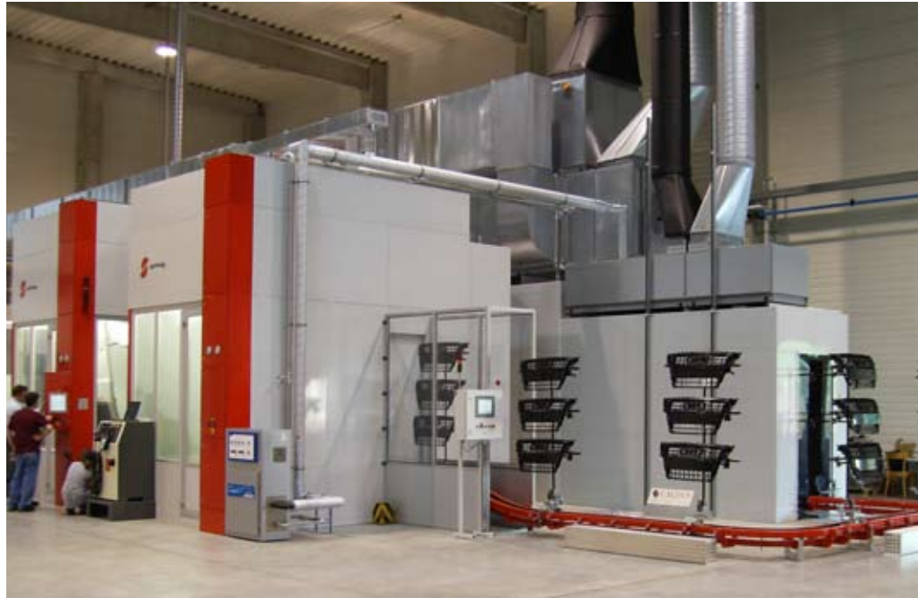
Blick auf die neue Lackieranlage der Bolta Werke in Diepersdorf. Mit der Investition hat der deutsche Automobil-Zulieferer den Beschichtungsprozess in die eigene Fertigung integriert. Quelle: Sprimag
